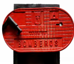
FIGURA 2: Arqueta vista superior
